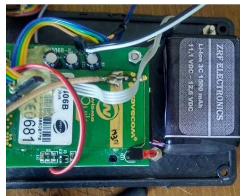
Gambar 7. Tata letak pemasangan baterai
